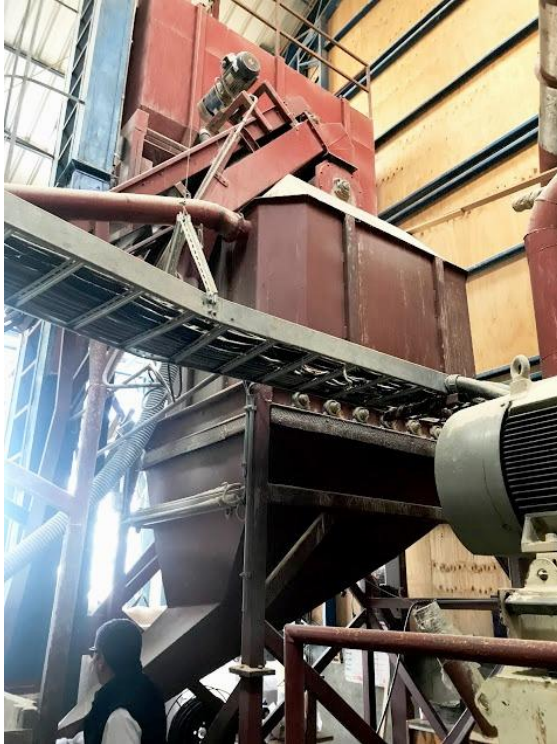
Figura 12. Equipo enfriador con aire a contracorriente
